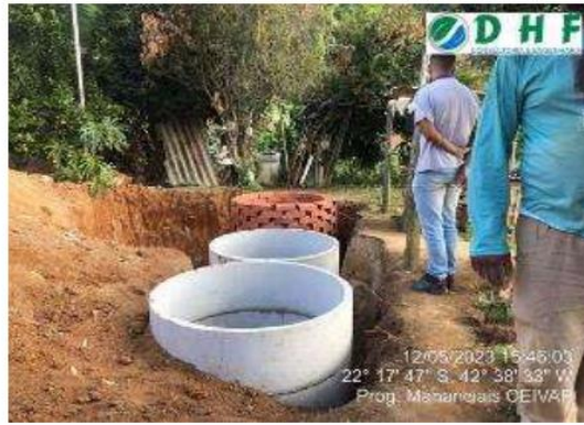
Sistema Fossa - Filtro - Sumidouro
