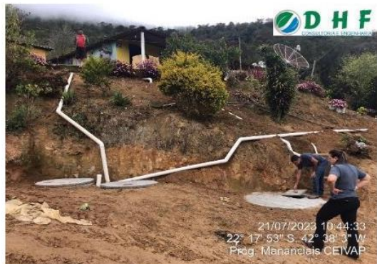
Sistema Fossa - Filtro - Sumidouro
