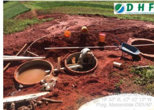
Sistema Fossa - Filtro - Sumidouro
